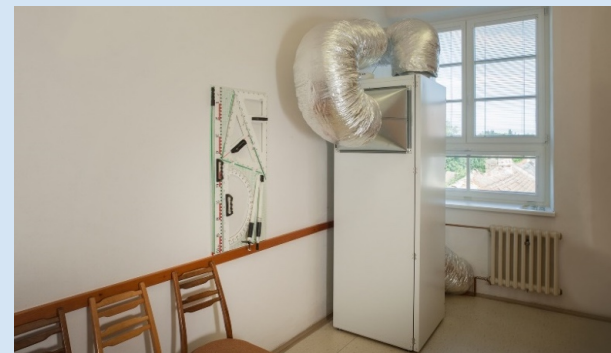
Obrázek 32 Výměník vzduchu na chlazení, ZŠ Jemnice. Zdroj: MŽP
