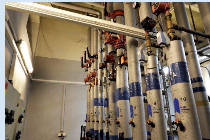
Obrázek 23 Regulace tepla a izolace rozvodů v ZŠ Trávníky Vsetín. Autor: Jaroslav Gerža
