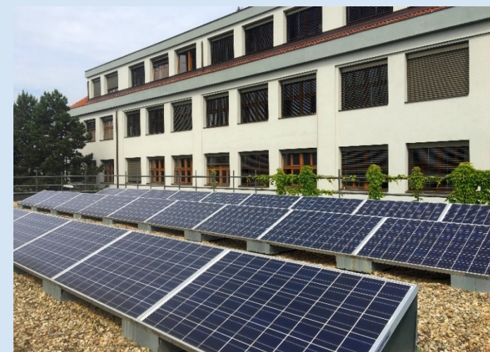
Obrázek 18 Fotovoltaické panely na střeše, ZŠ Kunratice
